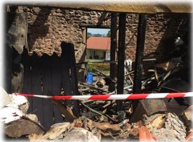
Dégâts sur la maison d'habitation de l'artificier (DREAL AURA)
