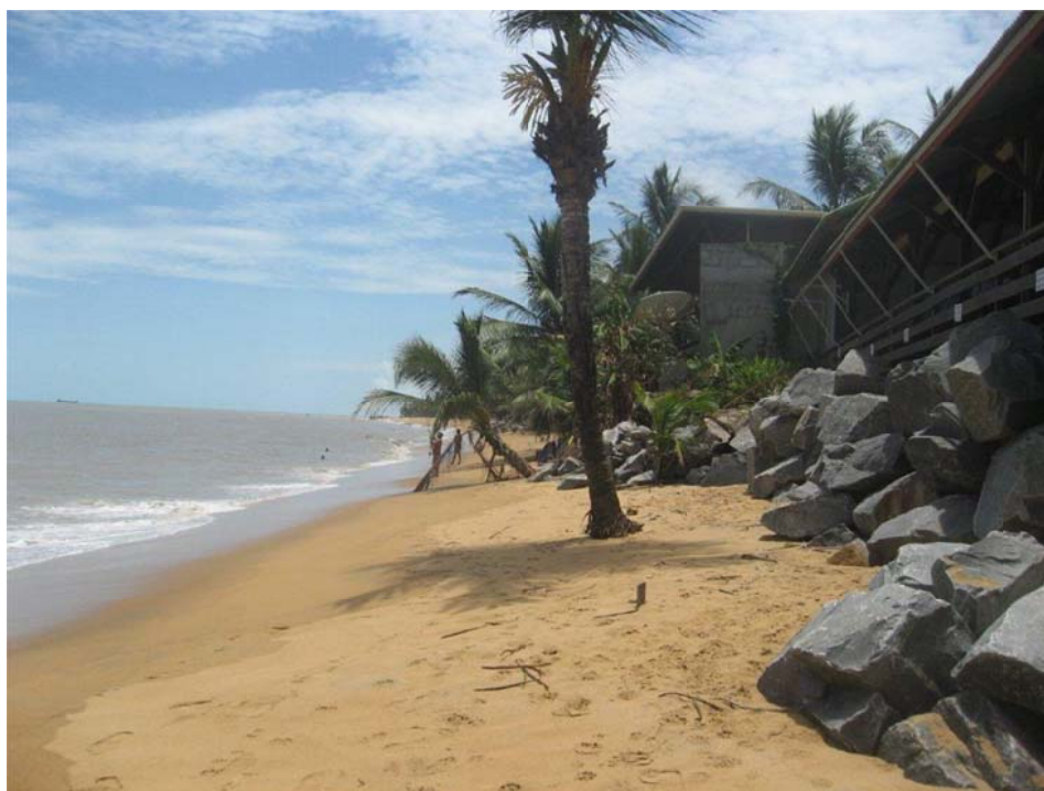
Figure 46 : Protection individuelle par empierrement (source BRGM Guyane)
