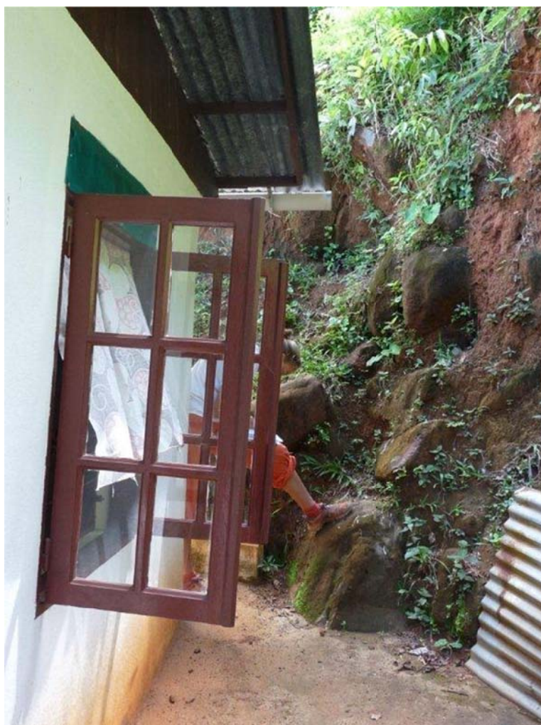
Figure 40 : Talutage mal géré induisant un risque d'éboulement (source BRGM Guyane)
