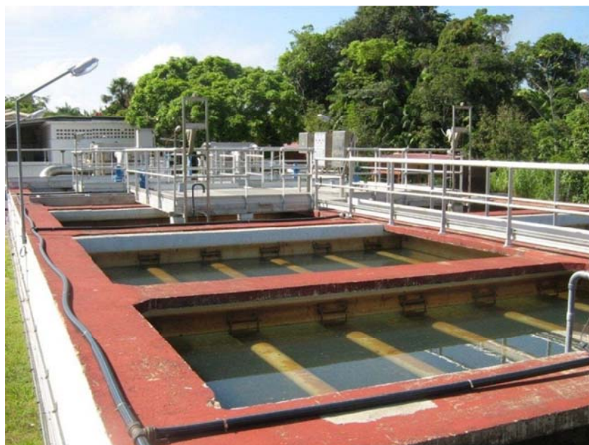
Figure 16 : Usine de traitement d'eau de la Comté alimentant le "grand Cayenne" (source BRGM Guyane)
