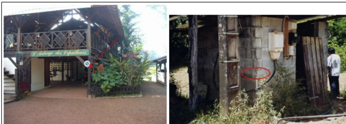
Illustration 14: Laisses de crue de mai 2000 à Roura (1.60 m au niveau du restaurant) et à Cacao (traces visibles sur les parpaings, soit 7.67 m NGG). AZI, Sogreah.
